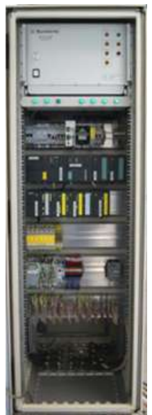
Baie Contrôle Commande
