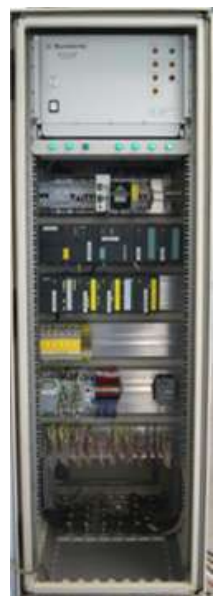
Baie Contrôle Commande
